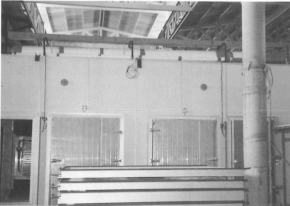
โครงการงานไฟฟ้าห้องเย็น ศูนย์บริการวิศวกรรมได้ออกแบบ ควบคุมงานไฟฟ้าทั้งหมด
